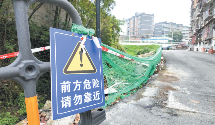
河堤护栏长期缺失。
