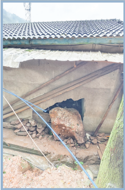
落石砸坏村民房屋。
