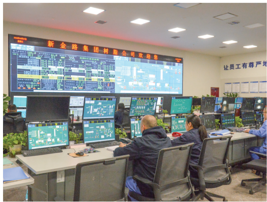
金路树脂中央控制室。
