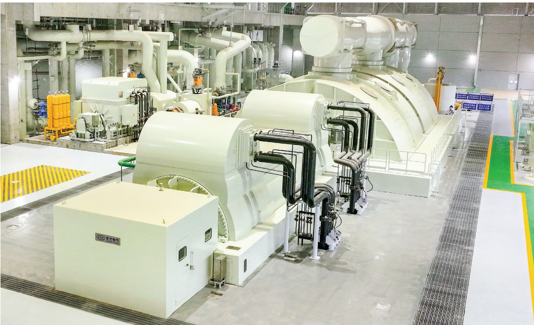
国内首个采用带功率平衡发电机双机回热系统超超临界一次再热百万千瓦机组正式投入商业运行。 受访者供图
