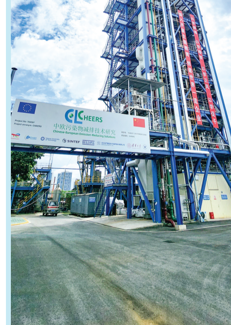
位于东方锅炉的世界最大化学链燃烧碳捕集示范装置。
